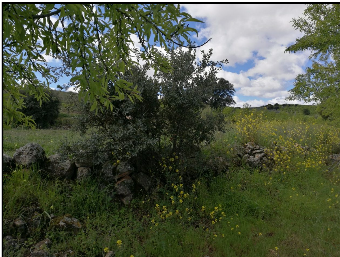
Vista detalle del muro de estabilización del talud Sur de la era.
