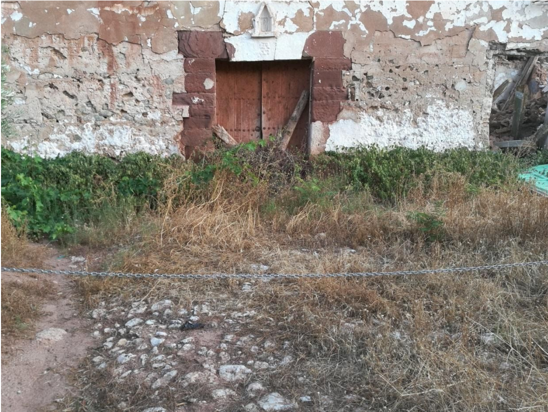
Detalle del empedrado en el lado Sur. Se aprecia su deterioro por aterramiento y cubierto de hierba
