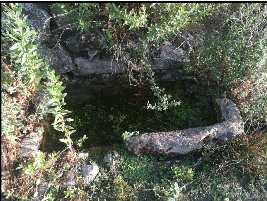
Vista de la Pila 3, se aprecia su deterioro con parte del borde escantillado.
