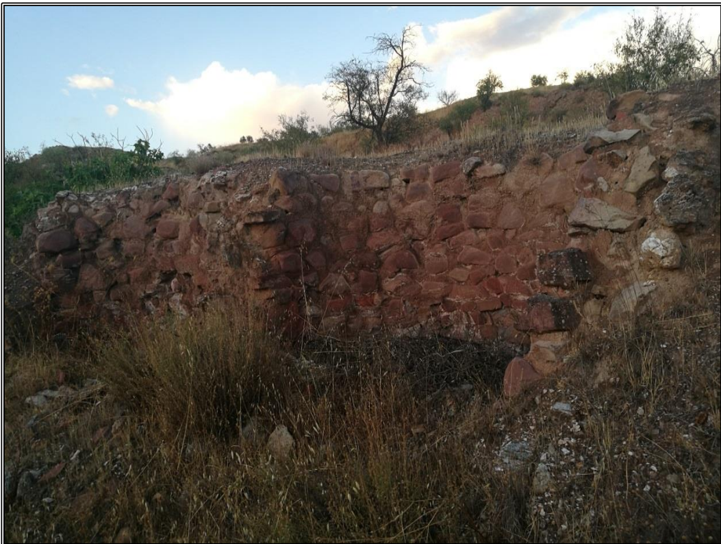
Detalle del estado actual de los hornos, completamente destruidos en su mitad Oeste.
