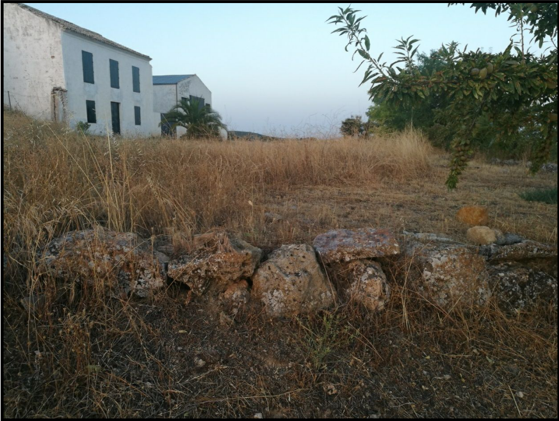
Vista del talud Sur de la era estabilizado con un pequeño muro de mampostería de piedra seca.
