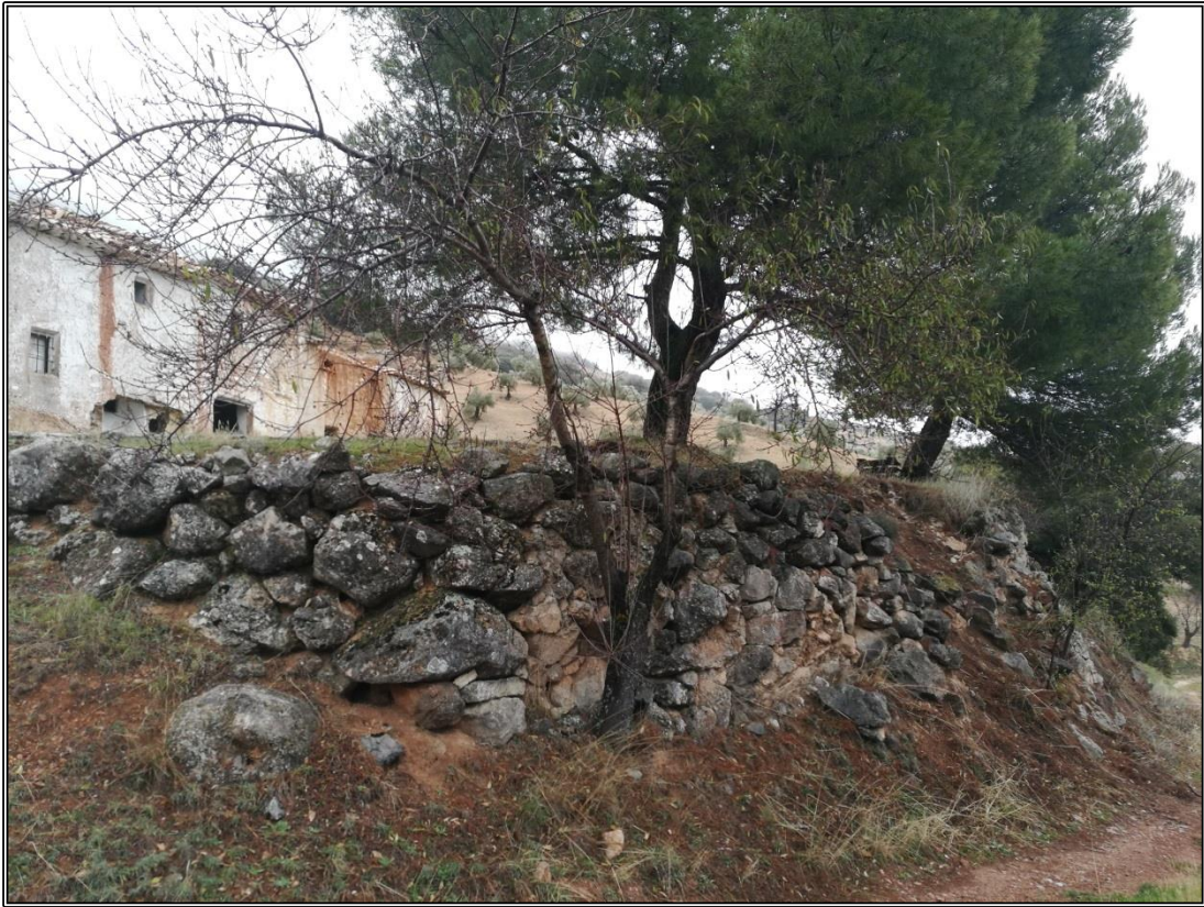
Detalle de la albarrada en piedra seca construida para estabilizar el terraplen de la era. Se aprecian partes parcialmente derruidas.
