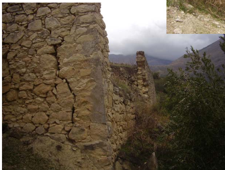
Foto 2. Vista del estado actual de la albarrada de contención.
